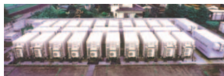
可搬型デジタル交換機
